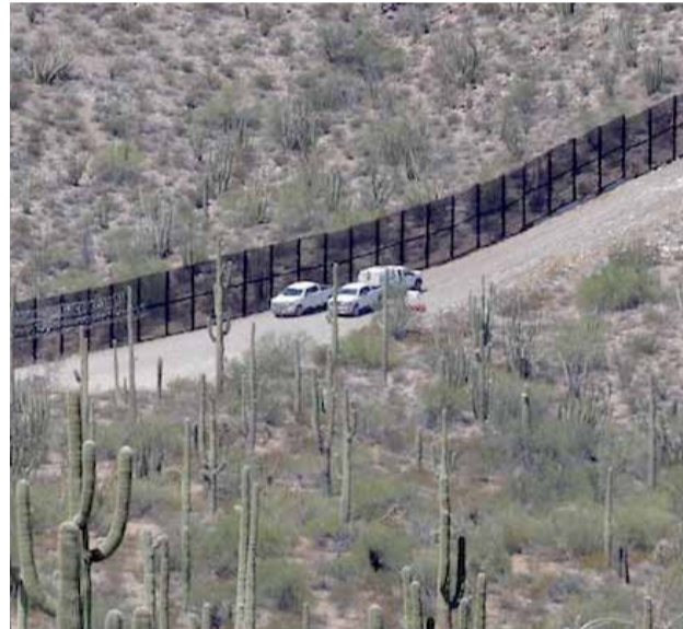
Durante toda la semana, las cuadrillas han retirado matorrales y la valla vieja en preparación para la instalación de los bolardos.
