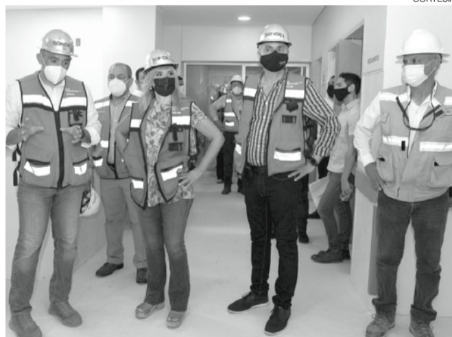
La gobernadora Claudia Pavlovich Arellano, supervisó los avances de la obra de construcción del nuevo Hospital General del Estado.
